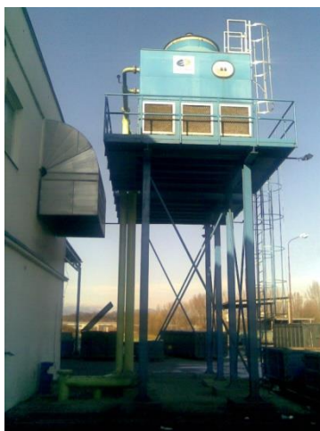
Obr. 9: Chladicí věž otevřeného systému
