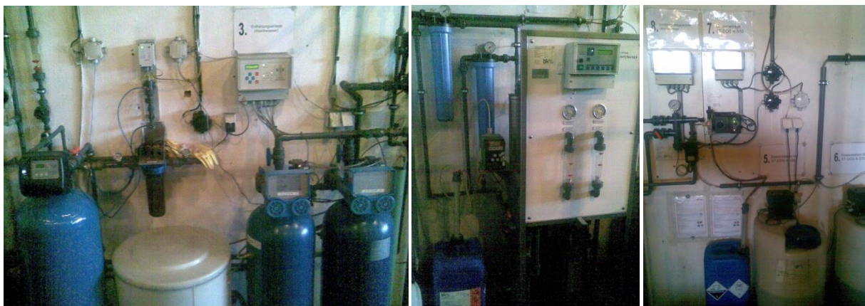
Obr. 11: Úprava chladicí vody v slévárenské praxi (změkčovače vody, filtry, osmóza, dávkovače inhibitorů)
