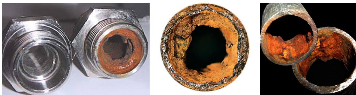
Obr. 1: Ukázky znečištění vodních rozvodů
